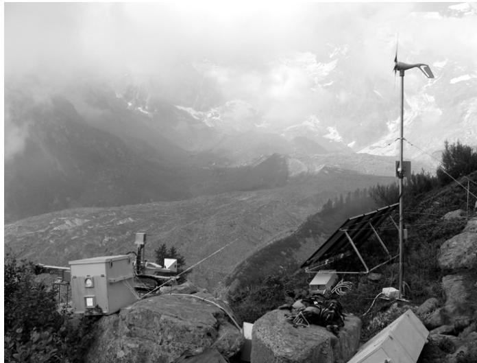
Figura 3 Installazione radar presso il ghiacciaio “Belvedere” sul Monte Rosa
