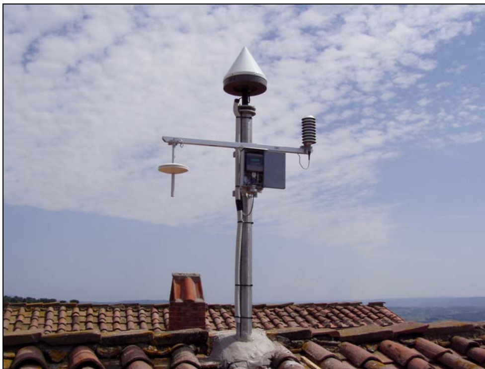
Fig. 2 – Stazione di Città della Pieve: antenna GNSS e stazione meteo su portantenna in acciaio inox; il portantenna è ancorato alla sottostante muratura portante di grosso spessore
