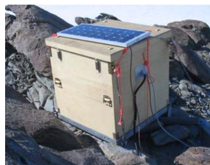
Figura 7 - Pannello fotovoltaico sopra il box
